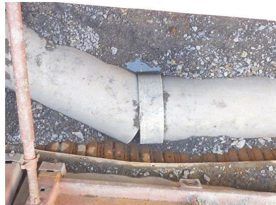
写真2 地震による継手の離脱の状況 (東日本大震災で震度6強の地震を受けた地区)
