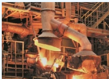
キュポラ溶解設備
