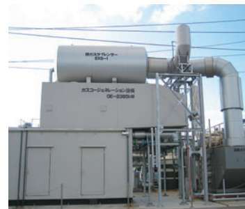
コージェネレーションシステム
