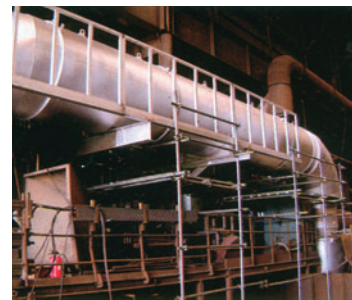
熱風をキュボラ炉内に輸送する熱風ダクト。
