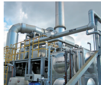
コージェネレーションシステム
