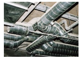
スパイラルダクト
