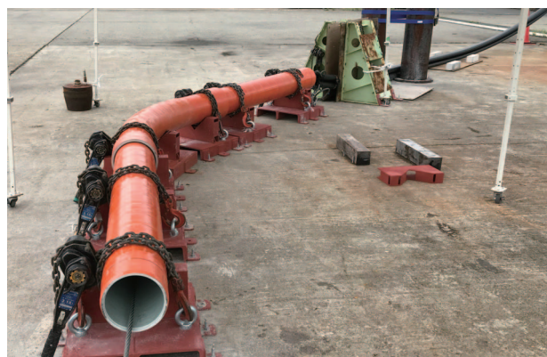
図8 45° 曲管部を持つ呼び径200のFRPM管路
