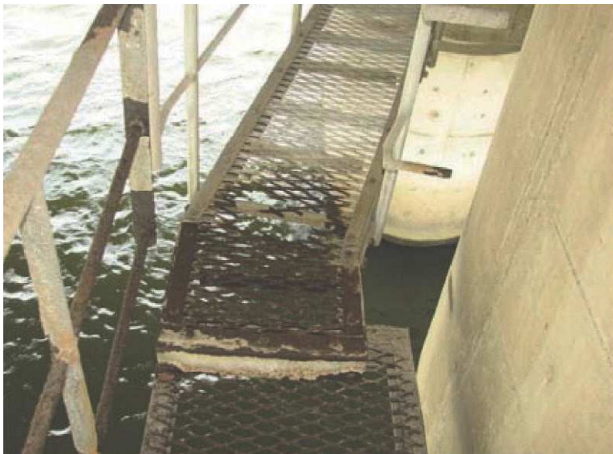
図3 腐食した鋼製検査路 (国土交通省 北陸地方整備局 橋梁点検ハンドブックから引用) 3)
