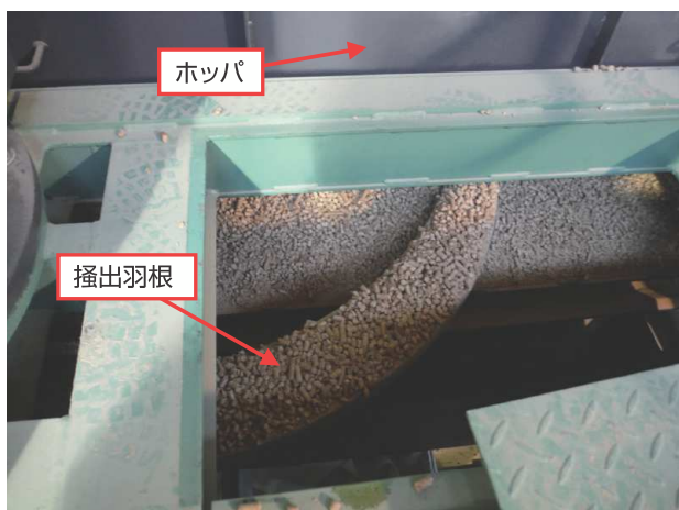
図18 木質ペレット 運転停止直後（上方より撮影）
