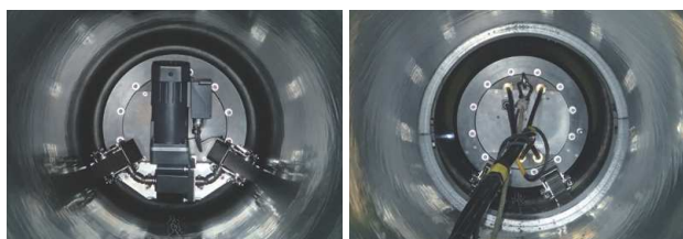
管内走行状況（駆動輪側）
