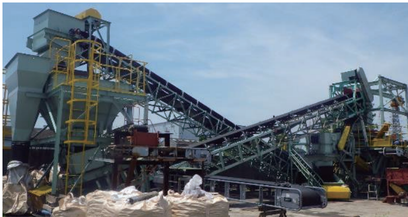
図5 石炭破碎選別総合試験設備
