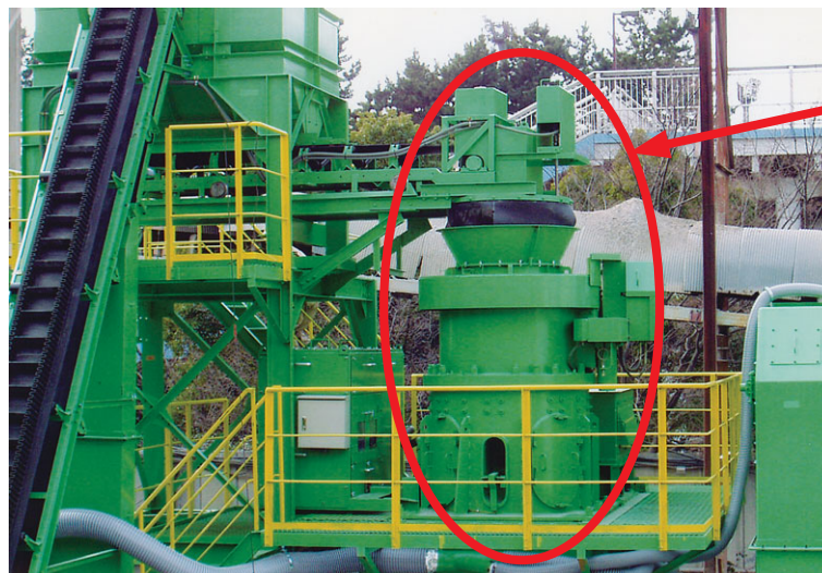
某所・「コンクリートリサイクルシステム」
